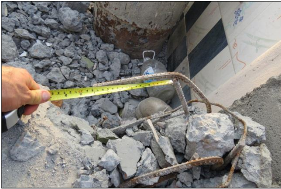
(d) Insufficient lap splice (close-up of c)
