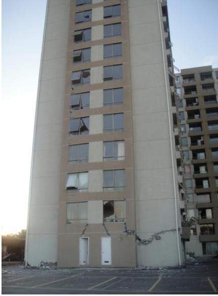
Shear wall failure, Plaza del Rio, Concepción.
